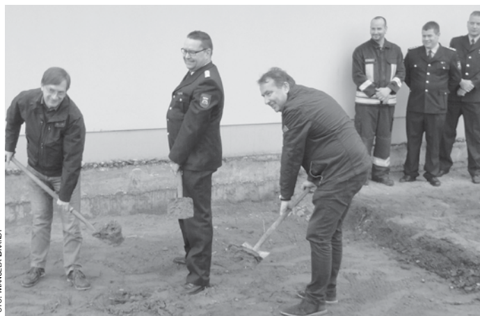
Ortsvorsteher Wilhelm Westerkamp, Ortswehrlführer Volker Rutte und Planer Peter Wenzel (v.r.) vollziehen gemeinsam den ersten Spatenstich für den Feuerwehrianbau in Finowfurt.
